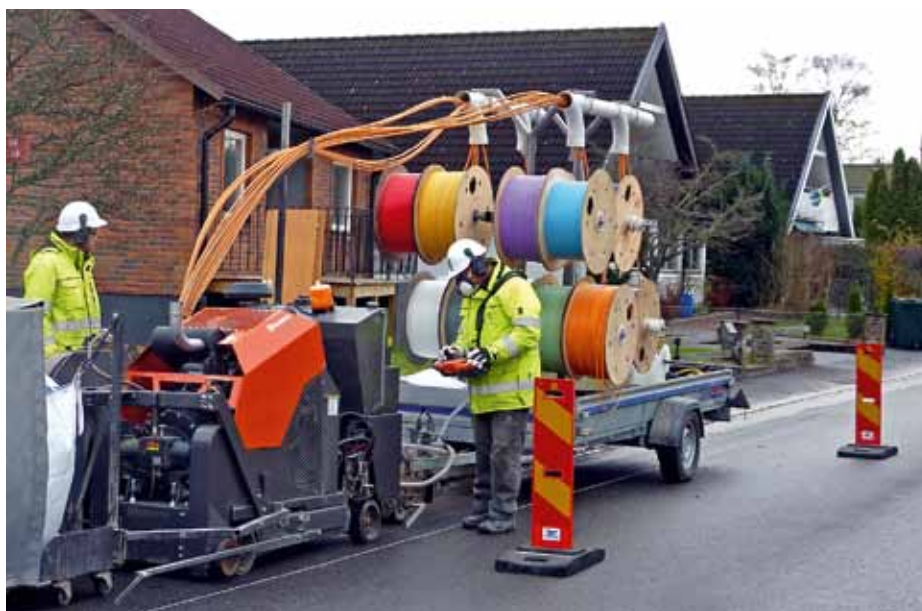
Första momentet består av att såga ett spår genom ytskiktet av asfalt eller betong och ned i underliggande bärlager. Samtidigt som spåret sågas installeras ett antal kanalisationsrör för fiberkabel samt sökråd.
